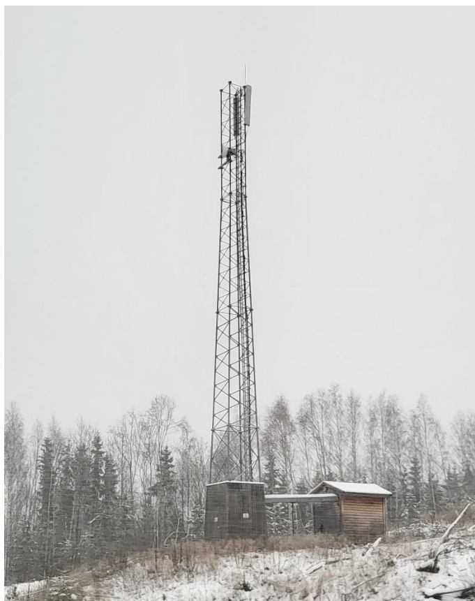
Figur 4 GSM-R -installasjon ved Tolpinrud, Hønefoss (foto: Tore Mundal, Rambøll)
