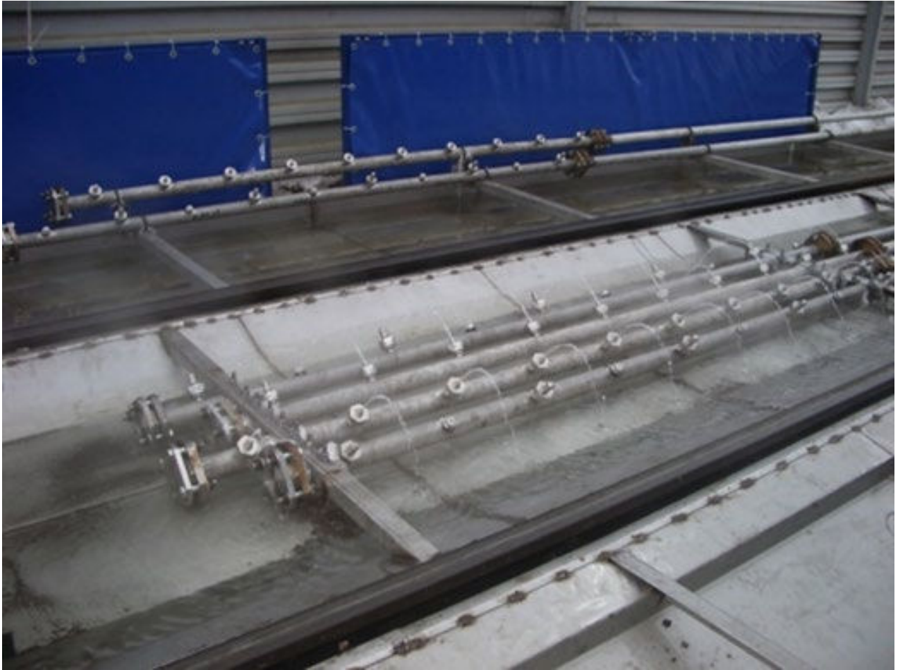
Figur 7-1 De-Icing anlegg på Alnabru. Foto: RailCombi, 2015
