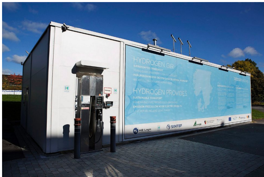
Figur 45: Hydrogenstasjonen på Gaustad, Oslo. Den fremstiller hydrogen ved elektrolyse fra strøm og vann, og leverer hydrogen ved 700 bar.
