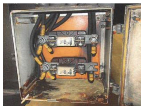
Figur 4 Sikringsboks som ble byttet i 2019
