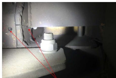
Figur 3 Skruer som har løsnet pga. sprekkdannelser
