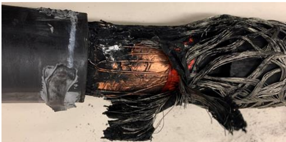
Bilde nr.: 2 – Skadet kabel
