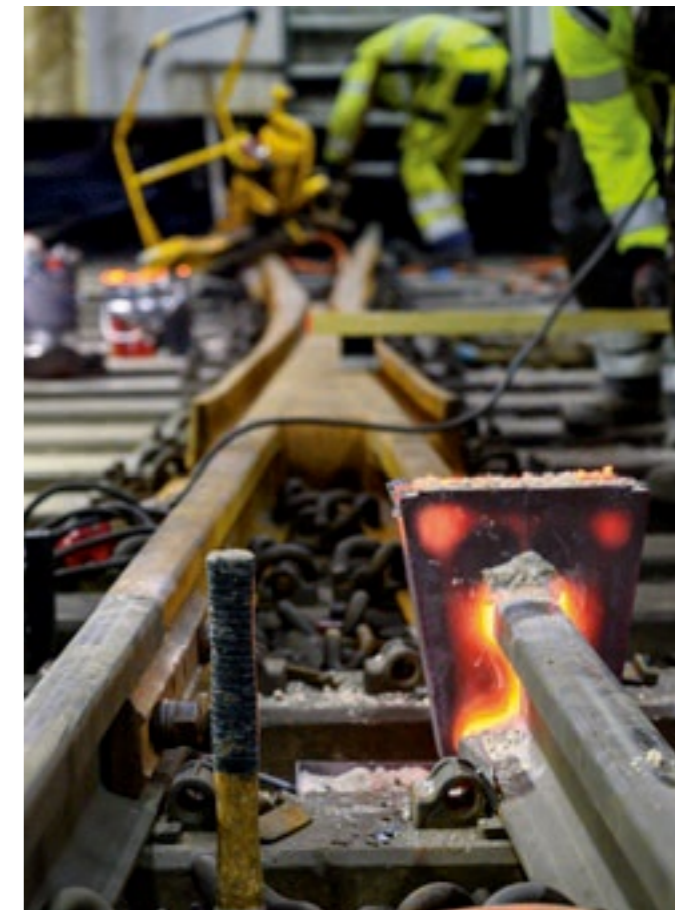
3000 GRADER: Skinnesveisen er straks klar til å bli klippet av med hydraulisk verktøy. Deretter følger sliping og finpuss med vinkelsliper.
