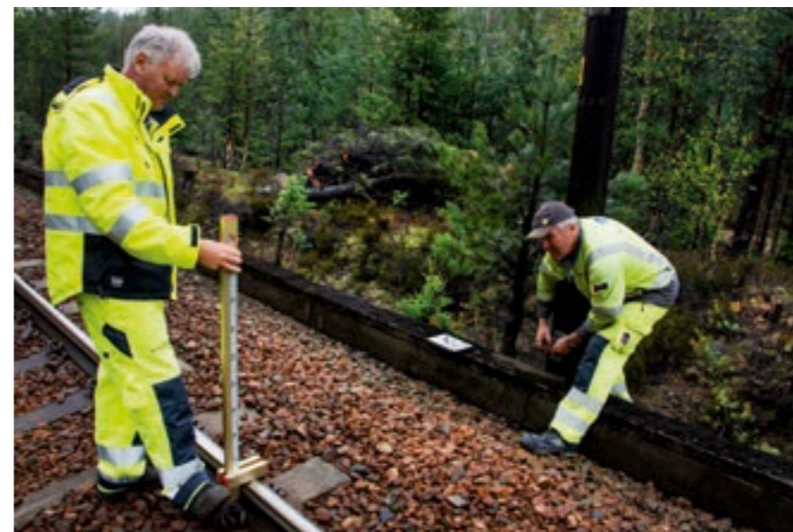
MÅLER: Her sjekker Hans Bjorvatn (t.v.) og Olav Øygarden at sporet ligger der det skal ved hjelp av lasermål til fastpunkt (VUL-mål).
