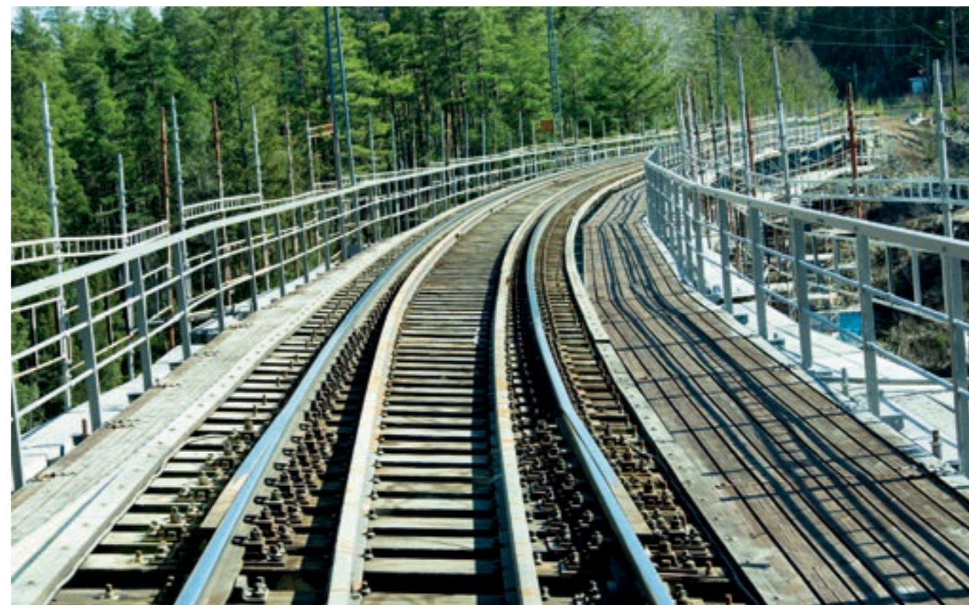
SVINGER SEG: Stål må bevege seg i takt med temperatursvingninger. Glideskjøt på Moripen viadukt. (Foto: Njål Svingheim)
