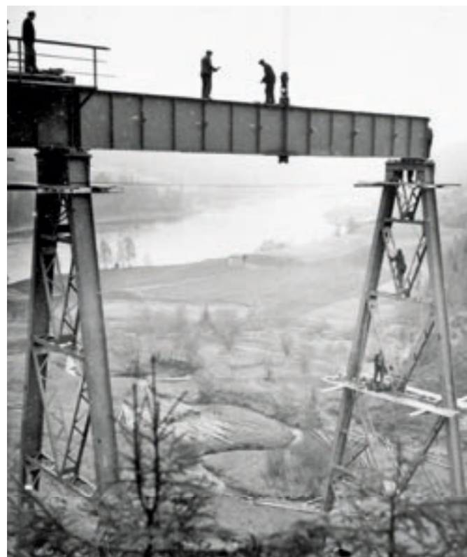
BRULAGET: Her bygges Trollalden viadukt som ble åpnet i 1938. Brua nord for Trofors stasjon ble, som mange andre jernbanebruer, bygd av brulaget til NSB. Hensynet til helse, miljø og sikkerhet var tydelig ikke det samme som i dag.
