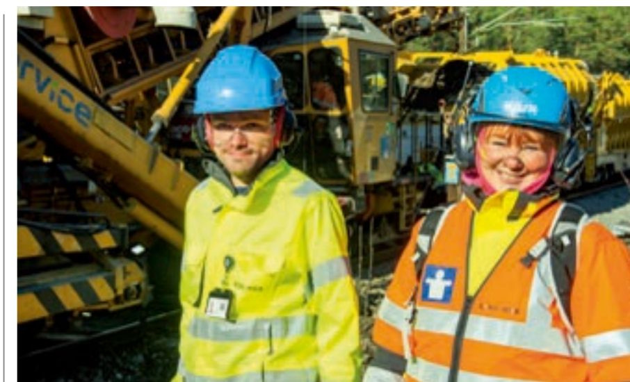
LEDER ARBEIDET: Prosjektleder Pål Buskum og byggeleder Pia Blom håndterer den omfattende logistikken som må til for å få ballastrensingen på Bergensbanen til å fungere.
