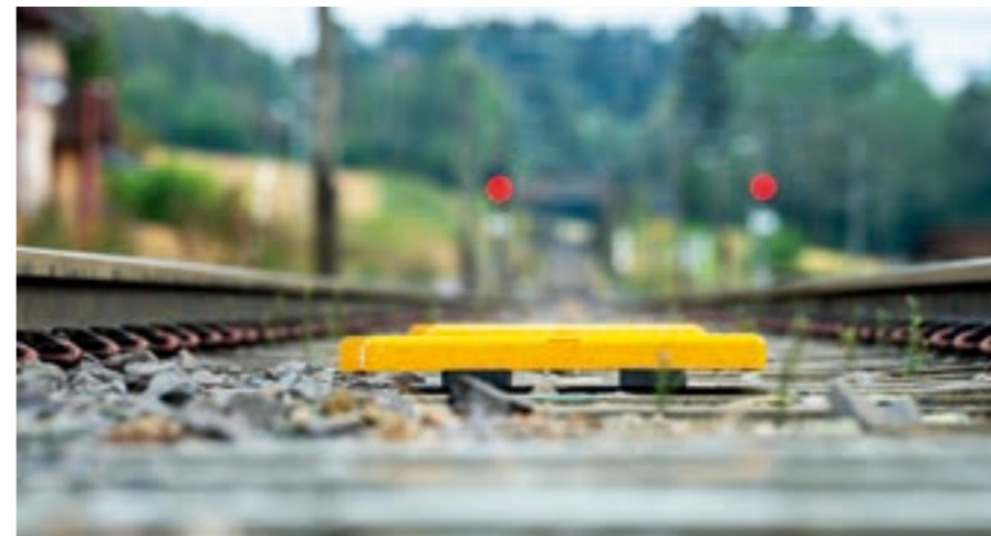
BALISE: Denne ERTMS-balisen testes på Grindvoll stasjon mellom Roa og Hønefoss. Signallysene i bakgrunnen kan etter hvert demonteres.
