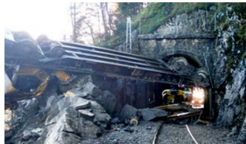
HELL I UHELL: Her gikk det veldig galt, til alt hell uten personskader. Et arbeidstog som begynte å trille av seg selv på Sørlandsbanen endte opp her.
