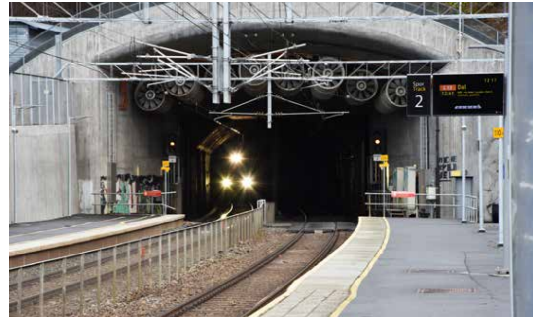
STOR JOBB: Lieråsen tunnel er en av landets tettest trafikkerte. Nå må den fornyes, selv om tunnelportalen her i Lier ble modernisert for vel ti år siden.
