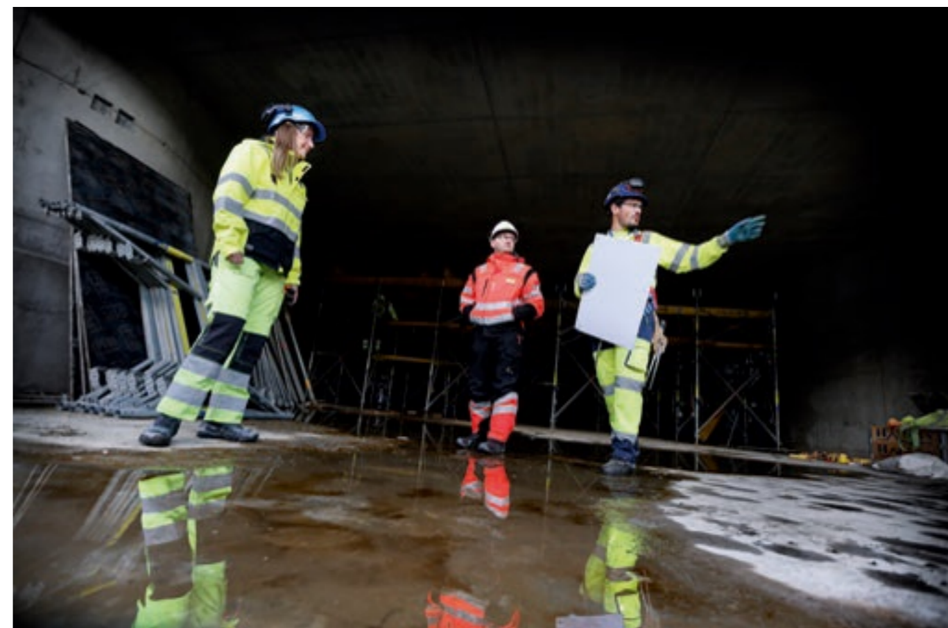
I RUTE: Kristin Slaaen Rørvik og Alberto Lorente (i midten) forsikrer seg om at alt er i rute i undergangen ved den nye stasjonen i Ski.
