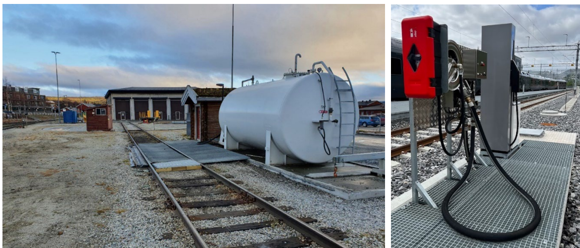
Figur 11: Fyllestasjon for diesel. Bildet til venstre er fra Røros hensettingsanlegg (svingskiven i bakgrunnen), mens bildet til høyre viser dispenser ved Støren påfyllingsanlegg (begge foto fra Network statement)
