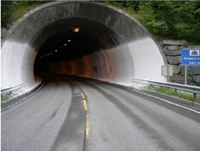
Figur 18. Kvitkalking i tunnel.
