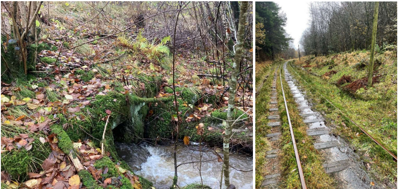
Figur 6-11: Til venstre et eksempel på en velfungerende tørrmurt stikkrenne, antakelig fra banens åpningsår. Til høyre et eksempel på gjengrodd grøfter og dårlig drenering (foto: Norconsult).
