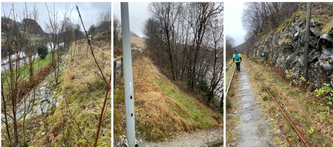
Figur 6-10: Til venstre erosjonssikring av fylling. I midten bratt skråning sør for Figgjo stasjon. Til høyre berg i dagen og løsmasseskråning (foto: Norconsult)
