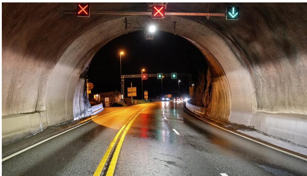
Kjørefeltsignal I Byfjordtunnelen
